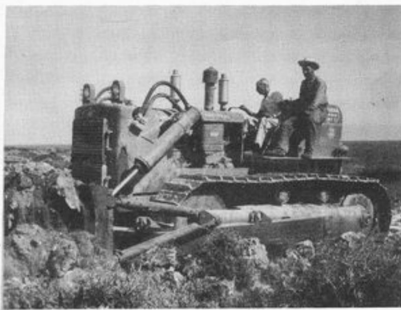
Al sur de la Península de Guanahacabibes, por encima del arrecife, las bulldozers del INRA construyen una carretera que irá de Cortés al Cabo San Antonio.
